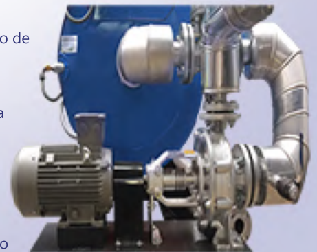
• Bomba de recirculación
